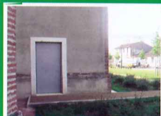
Sortie de secours
